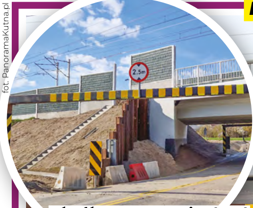
Józefów, w tym przejazd pod wiaduktem, niebawem przejdzie generalny remont.
